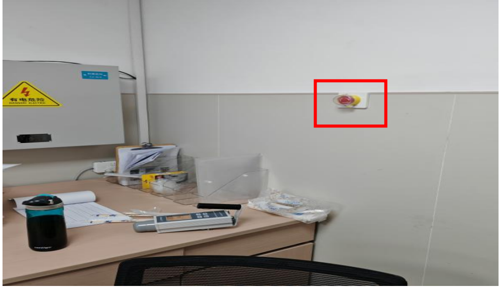
控制室内急停 按钮
